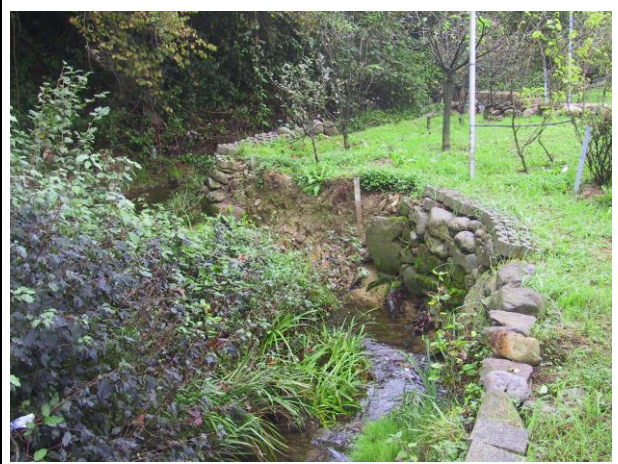
Foto 4: Erosione spondale lungo l'alveo del corso d'acqua BG06 prima dell'intervento di sistemazione idraulica (ottobre 2014).
